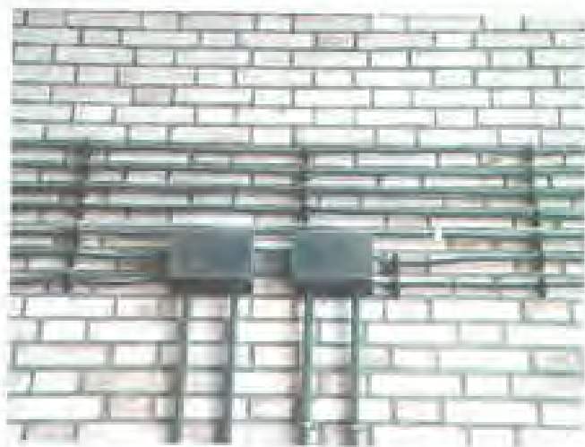
شکل ۵-۵۷- کابل کشی روی دیوار
