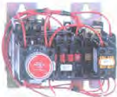
۱۱) تایمر پنوماتیکی نصب شده روی گنتاکتور
